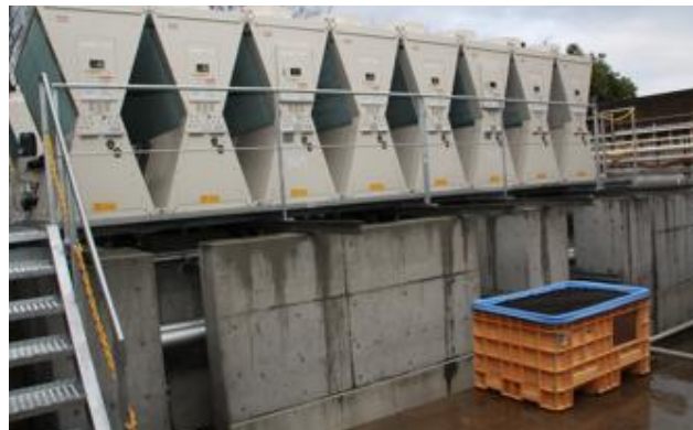
津波被害を避け、高い位置に設置された熱源装置
